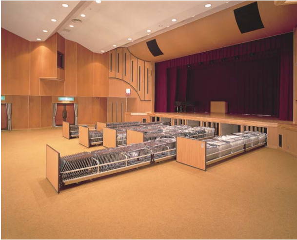
●レール・車輪および床面
